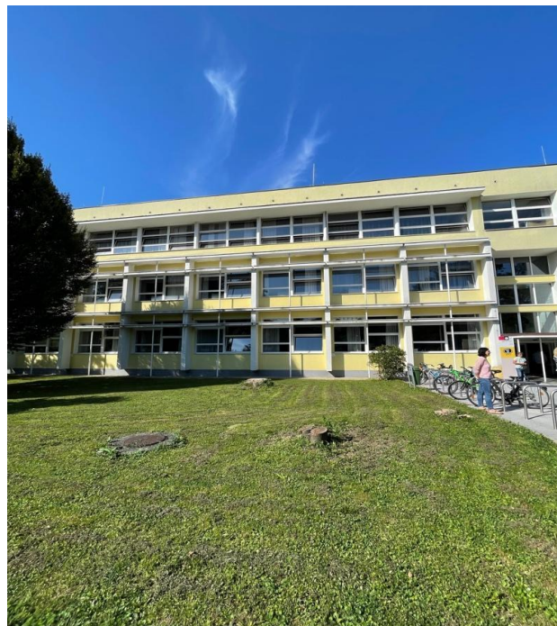
Slika 37: Štori podrlih dreves ter zunanja stran učilnic, nedavno izpostavljenih dodatnemu sončnemu obsevanju. (Foto: Leon Pritržnik)
