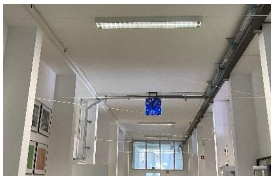
Slika 33: Obstoječa svetila na hodniku
